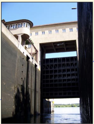
Zwillingschachtschleuse Eisenhüttenstadt UKW: Kanal 20 Tel.: +49 3364 40853
